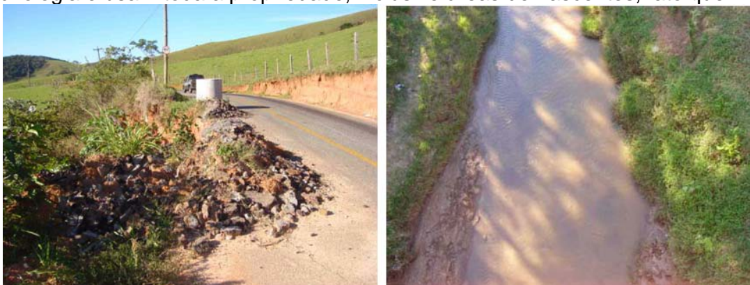
Figuras 2 e 3 – Impactos gerados nas sub-bacias (movimento de massa (Figura 2 à esquerda) e assoreamento de cursos d’água (Figura 3 à direita)
